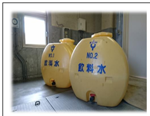
応急給水タンク保管状況
