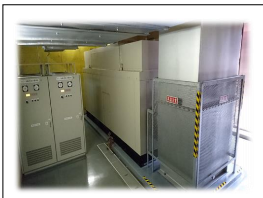
非常用自家発電機（浄水場）
