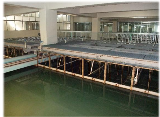
傾斜板沈降装置
